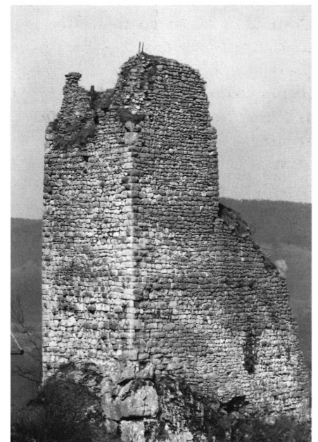
8: Etat des murs du cœur du château fort avant la restauration de 1998; vue du SW. Comparativement à la fig. 1 on remarque les pertes de substance des murailles des 140 dernières années.
