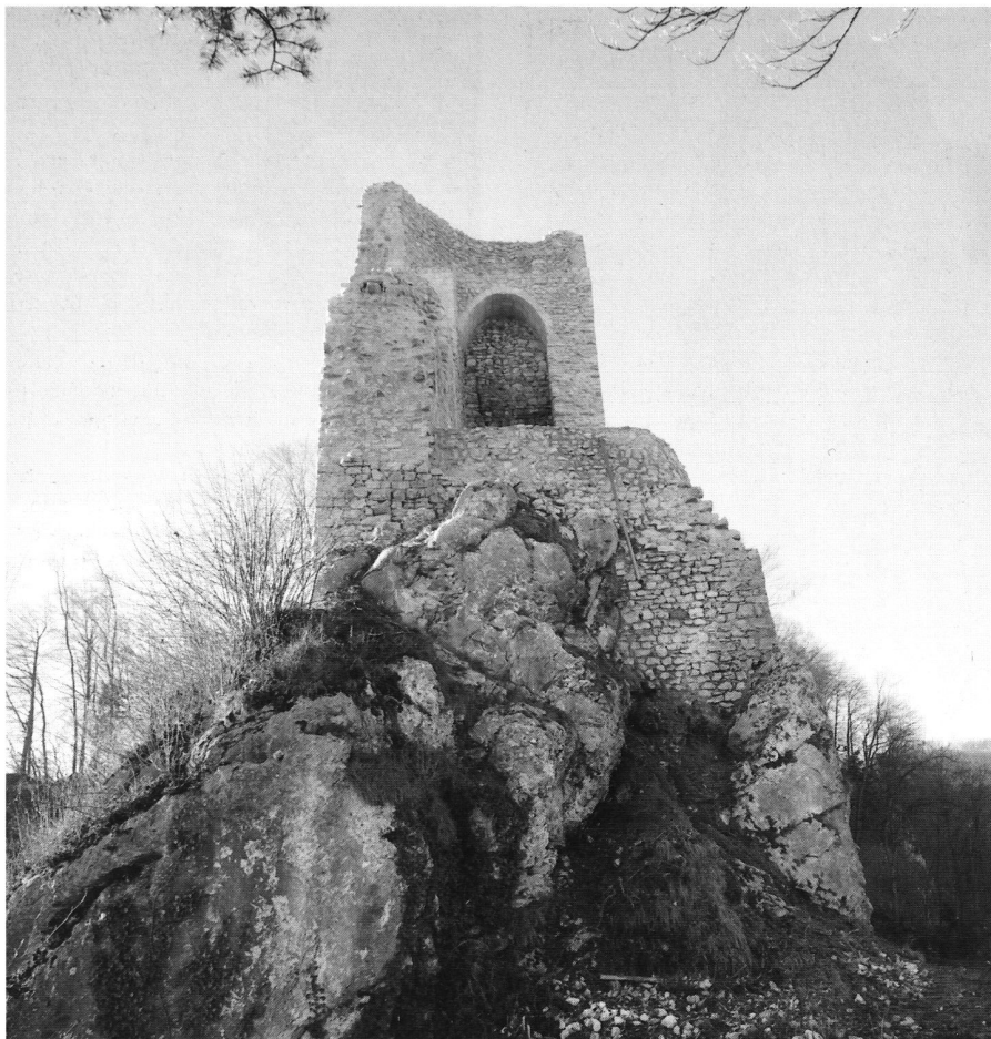
19: Château fort après la restauration complète de 1998; vue de l'E. A l'exception de la surface intérieure du mur M1 protégée par la voûte laissée dans son état d'origine, toutes les surfaces visibles des murs ont été restaurées.
