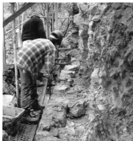
18: Mur M4. Deux maçons lors de la reconstruction de la façade effondrée pendant les travaux de consolidation; vue de l'W.
